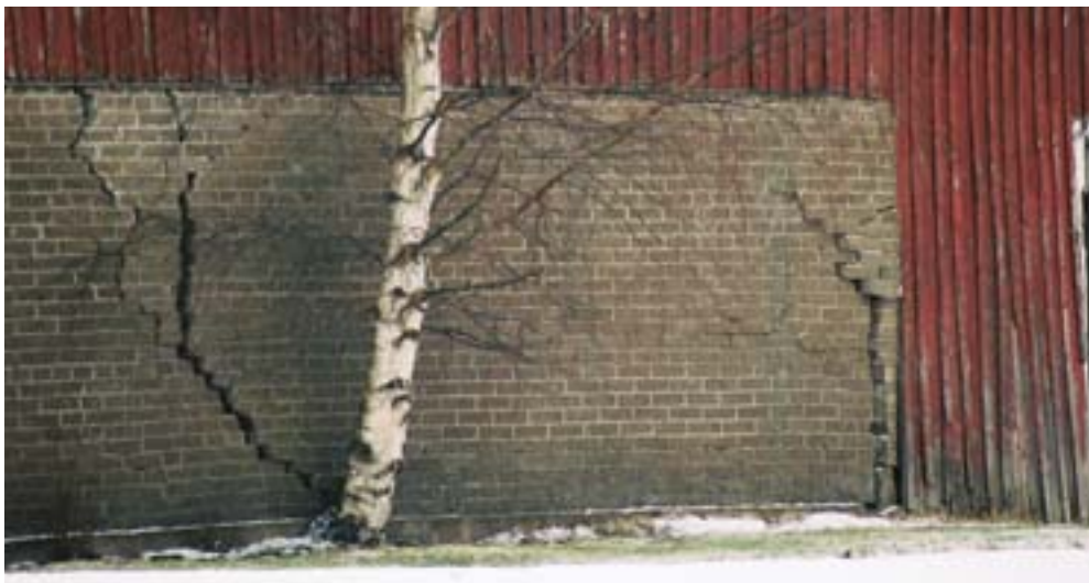
Tämänkaltainen halkeama on yleinen vaurio vanhassa "sementtitiiliseinässä". Perustus ja ulkoseinät ovat liikkuneet ja raudoittamaton seinä haljennut. Sokkelin viereen kasvanut koivu on yksi vaurion aiheuttajista. "Lumi tulee tupaan".
