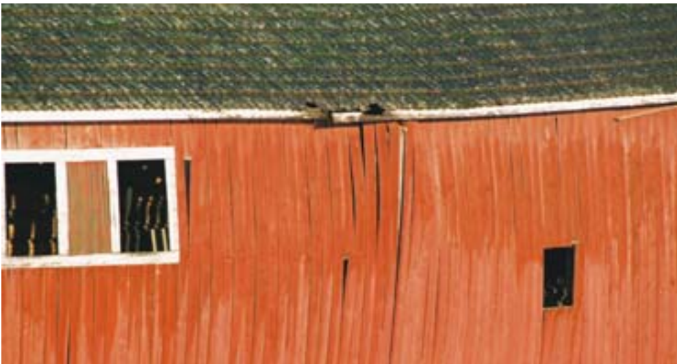
Vuotava vesikatto lahottaa ja tuhoaa nopeasti puurakenteisen rakennuksen.
