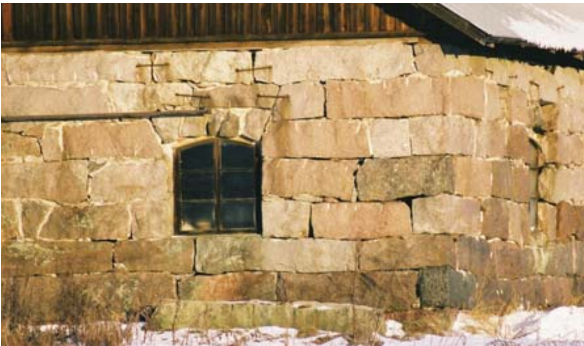
... lähempi tarkastelu paljastaa luonnonkiviseinän vauriot, jotka ovat korjattavissa, mutta saattavat aiheuttaa suuriakin kustannuksia.
