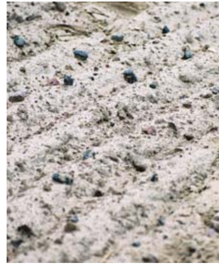
Liian ohuesta pintakerroksesta sekä vääränlaisesta sepelistä johtuen sepeli on noussut kentän pinnalle.
