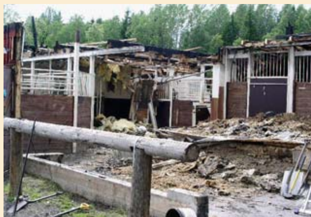
Palaneen tallin raunioiden raivaaminen ja jälkien korjaaminen alkoi jo palopäivän iltana. Kengitystila, pari karsinaa ja kuivaushuone ovat osittain säästyneet mm. välipohjan lasivillaeristeitten ansiosta, mutta muuten talli on käytännössä tuhoutunut.
